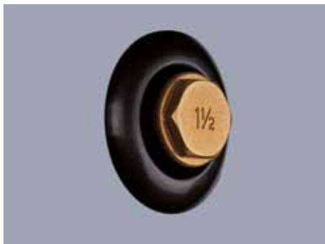
Heizungsanschluss ohne Abdeckkappe
