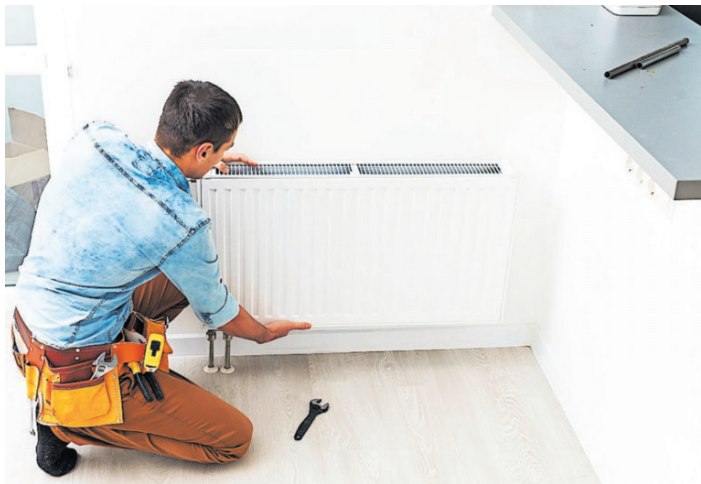
Regelmäßige Wartung von Heizanlage und Heizkörpern spart Energie und Geld.
