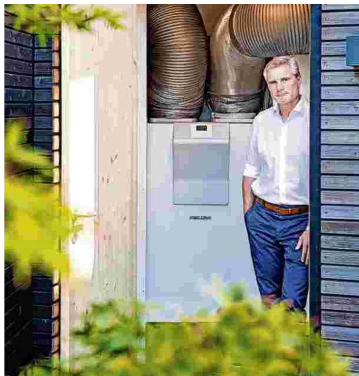
Die vernetzte Wärmepumpenheizung lässt den Energieverbrauch steuern
