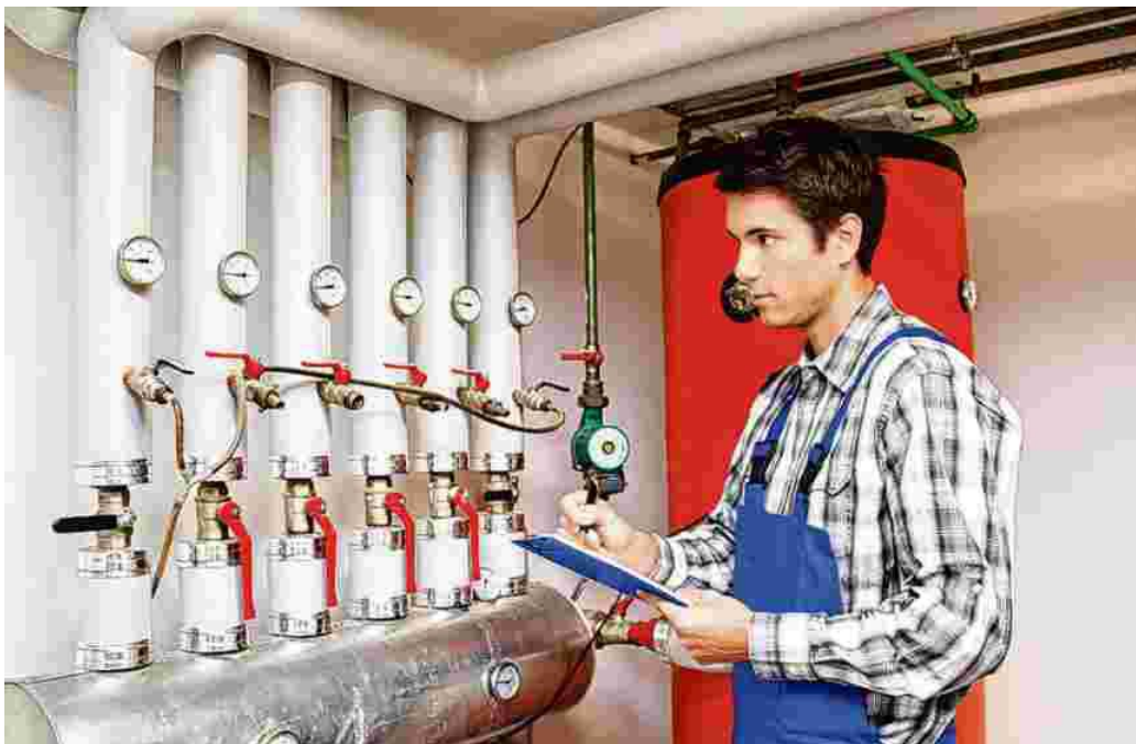
Mit der Überarbeitung von Anlagen lassen sich deutliche Einsparungspotenziale erzielen. Foto: Wodicka
